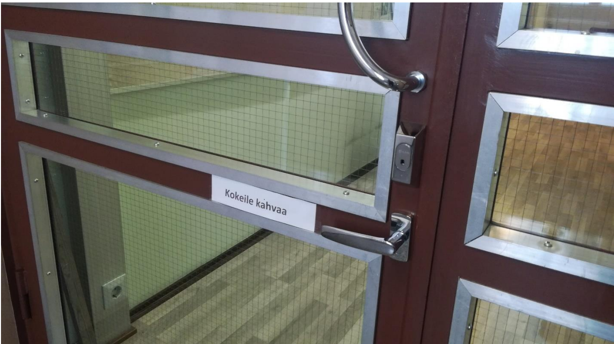
Kuva. Rakennuksen väliovet ovat tyypillisiä 1980-luvun lasimetalliovia, joiden lasiosat onrautalankaverkolla vahvistetut.
